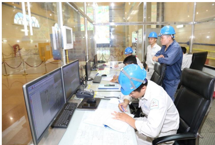
Phòng điều hành nhà máy thủy điện Lai Châu. Nguồn: Báo Lao động
